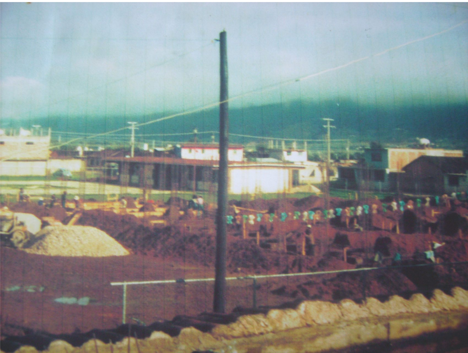
1979. Construcción del edificio de Antropología de la entonces Área de Ciencias Sociales. Fondo Imágenes Digitales, Sala 1/AHFCS Archivo Histórico de la Facultad de Ciencias Sociales.
